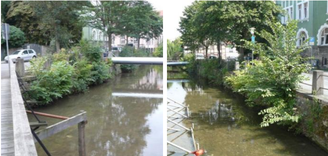
Abb.: Zustand der Ufermauer vor der Sanierung
