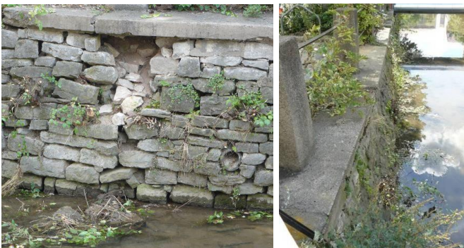
Abb.: Loses Mauerwerksgefüge, stark mit Grün durchwachsen
